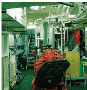
maszynownia engine room
