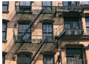
wyście ewakuacyjne fire escape
